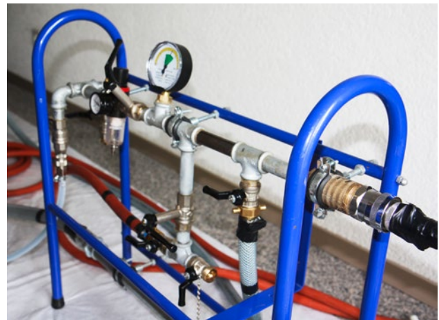
Spülstation mit Drucküberwachung
