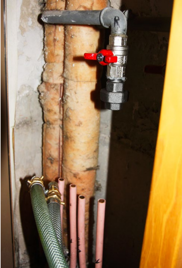
Spülung direkt beim Fussbodenheizkreis (N)
