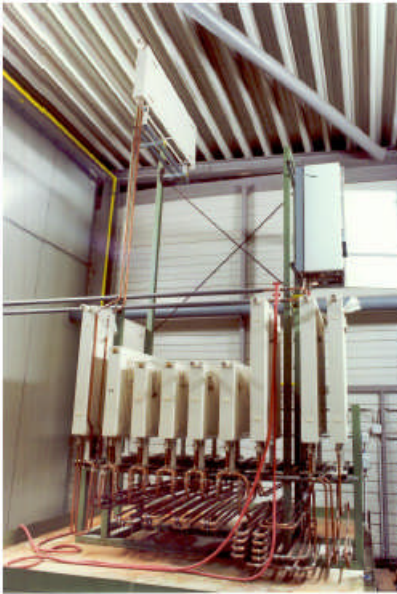
Abbildung 3: Versuchsaufbau in Anlehnung an eine Kundenanlage.
